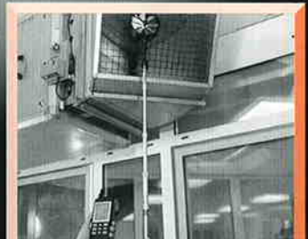
ダクト吹き出し口の風量 計測 (演算)
